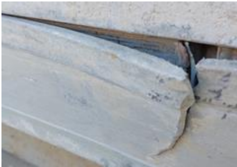
Puknut uzdužni profil okvira
