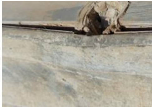
Oštećena rupa za sidra i deformiran profil
