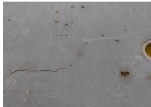
Pukotine na ploči > 10 cm dužine
