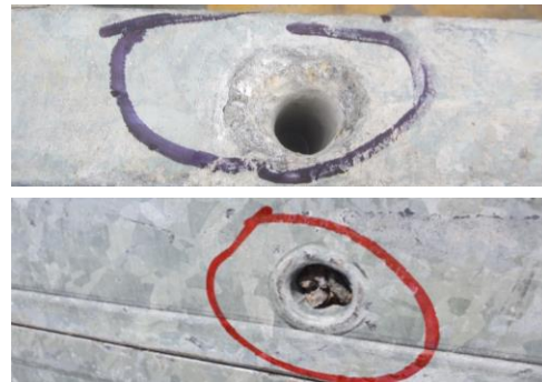
Rupe za sidra na profilu oštećene ili ispunjene betonom
