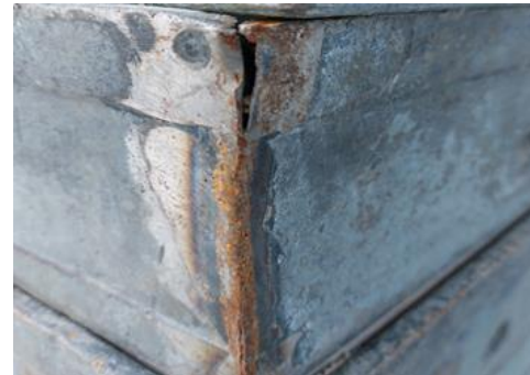
Razdvojenost profila okvira, puknuće varova
