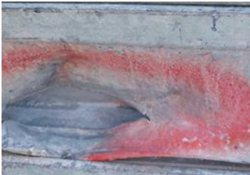
Puknut uzdužni profil okvira
