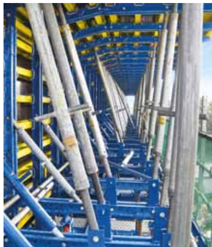
▲ 桥面板和侧壁模板由大面积模板 Top 50 组成，设计用来承载混凝土重量，并且可以用作增加安全性的工作平台。
