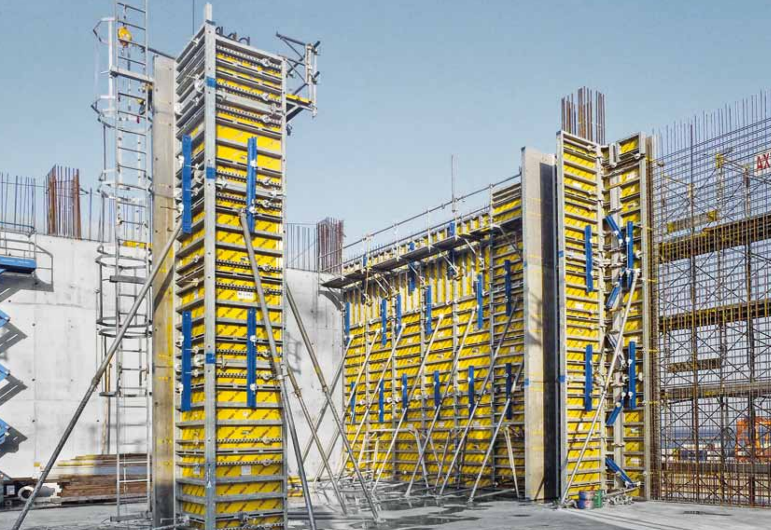
▲ 多卡日本被选择为某项目提供墙模和柱模建造一座大型钢筋混凝土冷藏仓库。
