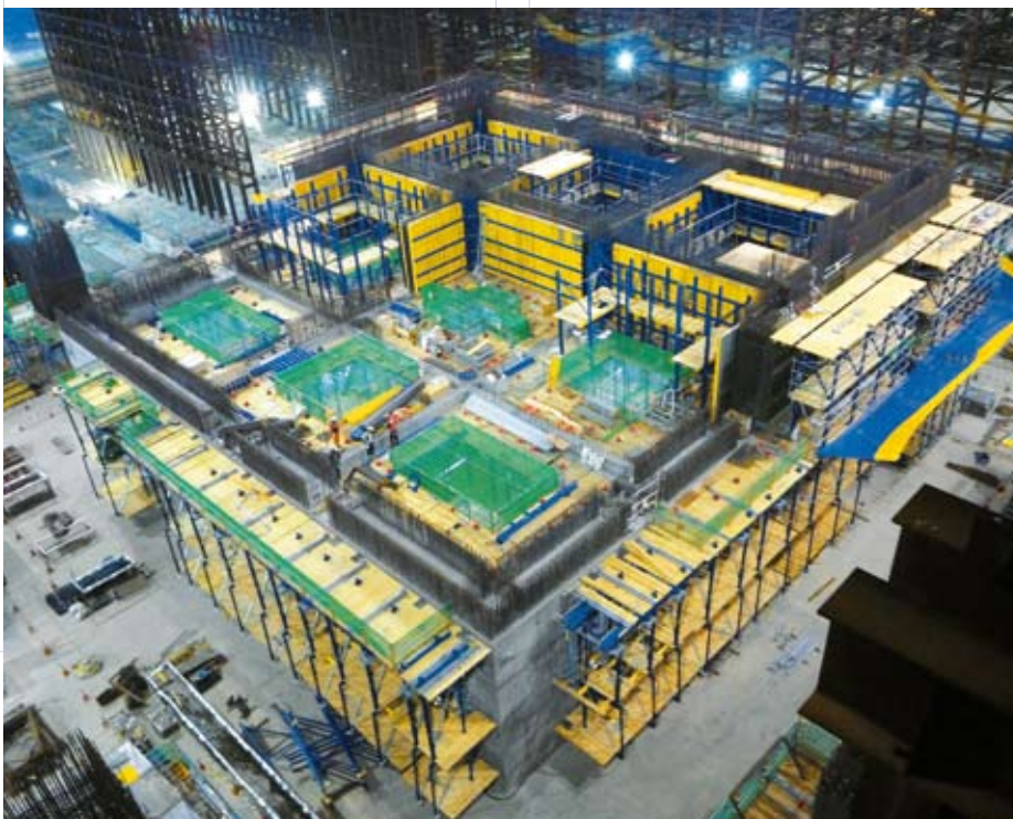
◀ 코어용 Auto Climbing Formwork System SKE100은 현재 조립 및 설치 중이며, 144개의 SKE100시스템이 Large area formwork와 C.P.B를 인양하게 된다.
